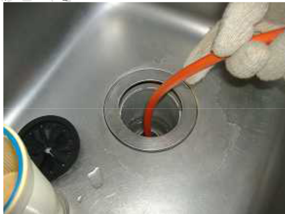
流し台排水管
